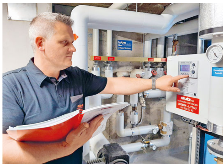
Denis Gajski, Projektleiter und Co-Geschäftsinhaber der Littauer Stutz AG, Heizungen und Lüftungen, vor einer Fernwärmanlage im Littauer Matthof.
